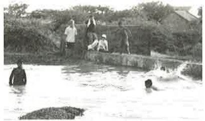
写真3 2001年8月、バラチャディ村で完成したチェックダム。完成翌日の豪雨により、写真のように水が溜まった。
