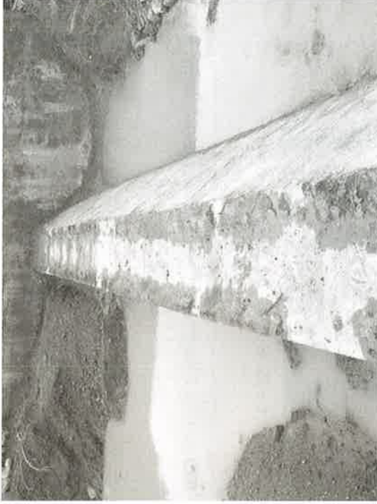
写真2 ダム堤の高さ3m、堤頂幅1m、長さ30m。設計耐震強度はマグニチュード8.0。(筆者撮影 インド・ジャムナガル市 2001年7月10日)
