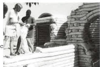
Cal-Earth 研究所（カリフォルニア州）のサドバック技法を用いた被災地向けシェルター・モデルハウスの建設のようす
